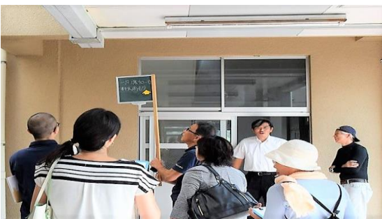
教頭先生の案内で校内を視察。 1階渡り廊下軒下で雨漏りを発見。指摘事項第1号
